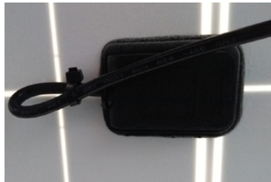
Abb. 10: Beispiel für ein Kabel, das die Junction Box unter einem extremen Winkel verlässt
