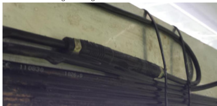
Abb. 11: Bei einer Befestigung des Steckverbinders direkt am Montagesystem kann sich Feuchtigkeit zwischen Steckverbinder und Schiene bilden und die Verbindung beschädigen.
