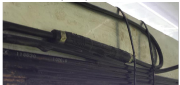
Abb. 10: Bei einer Befestigung des Steckverbinders direkt am Montagesystem kann sich Feuchtigkeit zwischen Steckverbinder und Schiene bilden und die Verbindung beschädigen.
