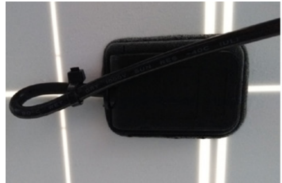
Fig. 9: Ejemplo de cable saliendo de la caja de conexiones en un ángulo extremo
