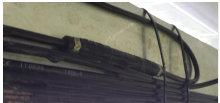
Fig. 10: Una fijación apretada del conector a la estructura de montaje puede provocar la acumulación de humedad entre el conector y el rail, lo que dañará la conexión
