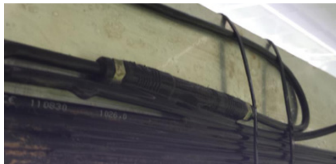
Fig. 11: Una fijación apretada del conector a la estructura de montaje puede provocar la acumulación de humedad entre el conector y el rail, lo que dañará la conexión
