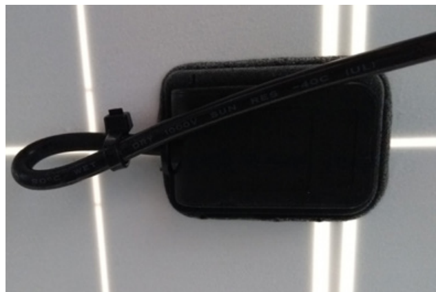
図10: ジャンクションボックスから延びるケーブルを鋭角に曲げた例
