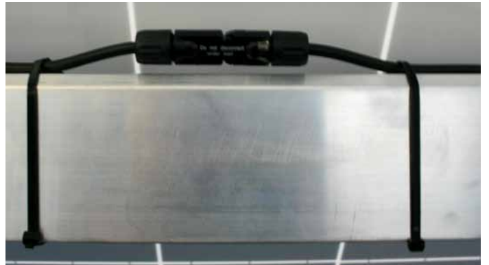
図10: コネクタではなくケーブルで固定された例。コネクタ周囲に空気循環が確保されていることがわかります。
