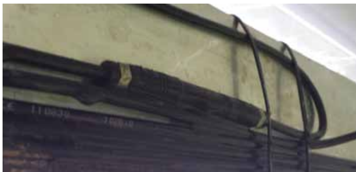
図9: コネクタがレールに固定された例。コネクタとレールの間に湿気が滞る可能性があります。この場合、電氣的接続に不具合が発生する可能性があります。
