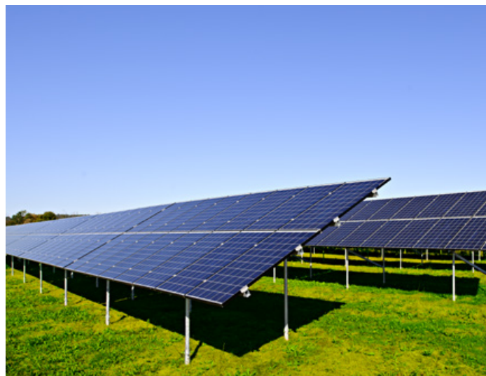
Fig. 3: Solaranlage nach der Reinigung
