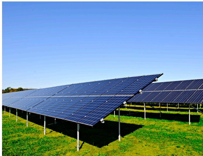
Fig. 3: Una instalación solar limpia y en funcionamiento
