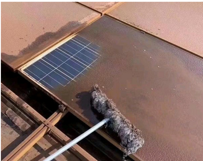
Fig. 2: Paneles solares con polvo.
